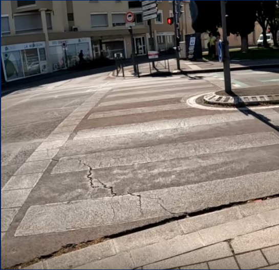
Passage piéton avenue du colonel Beltrame correct mais vieillissant de côté.
